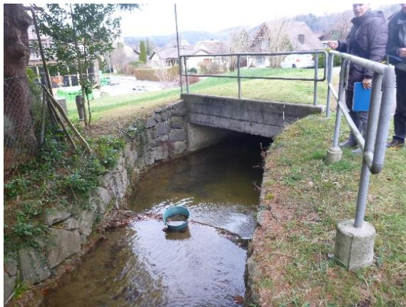
Eindolung bei km 0.36 (Huebweisstrasse)
