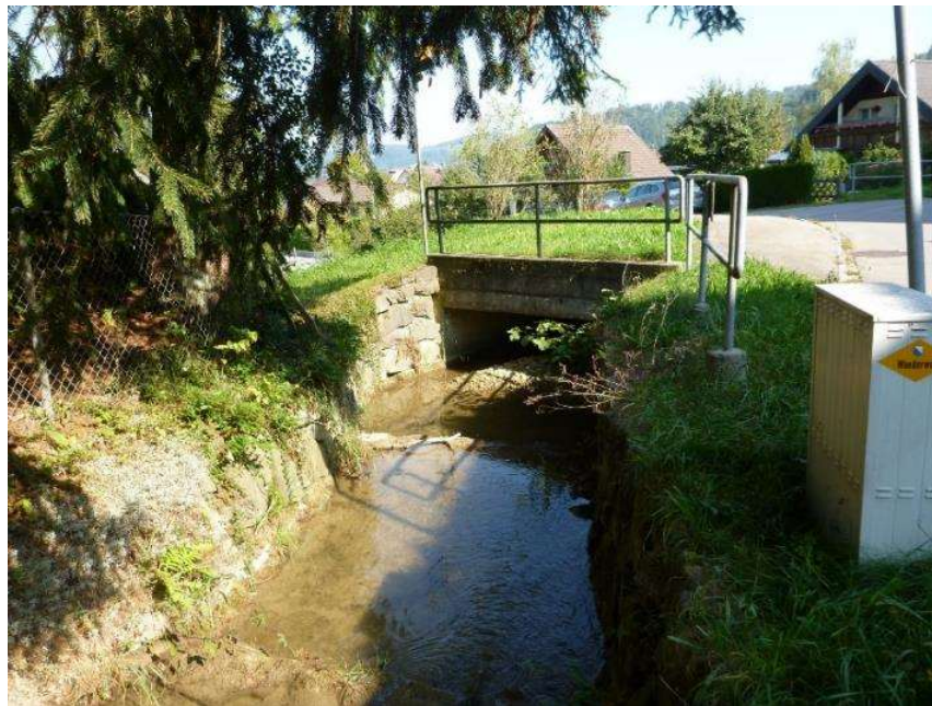
Abbildung 9: Geschiebeablagerungen im Bereich der Brücke Huebwiesstrasse
