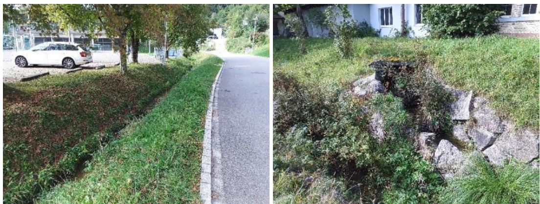
Abbildung 40: Der Weiherbach beim stark beeinträchtigten Abschnitt Wei-04 (links, Blick gegen Fliessrichtung) und der Ausfluss aus der Eindolung bei Wei-01 vor der Einmündung in den Mülibach
