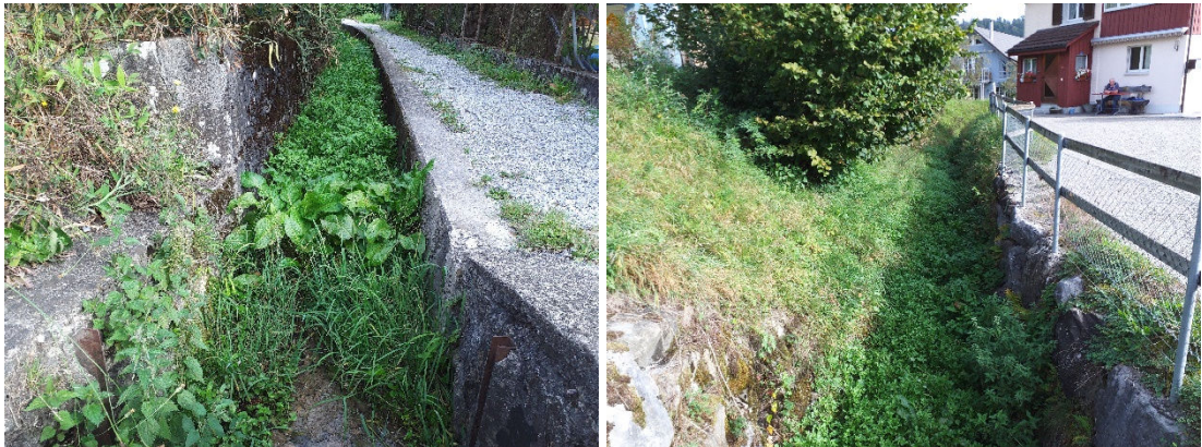
Abbildung 54: Blick in Fließrichtung auf den Rechteckkanal am Lochbach Abschnitt Loc-03 (links) und Blick in Fließrichtung auf den offen verlaufenden Abschnitt Que-02 des Quellbachs (rechts)
