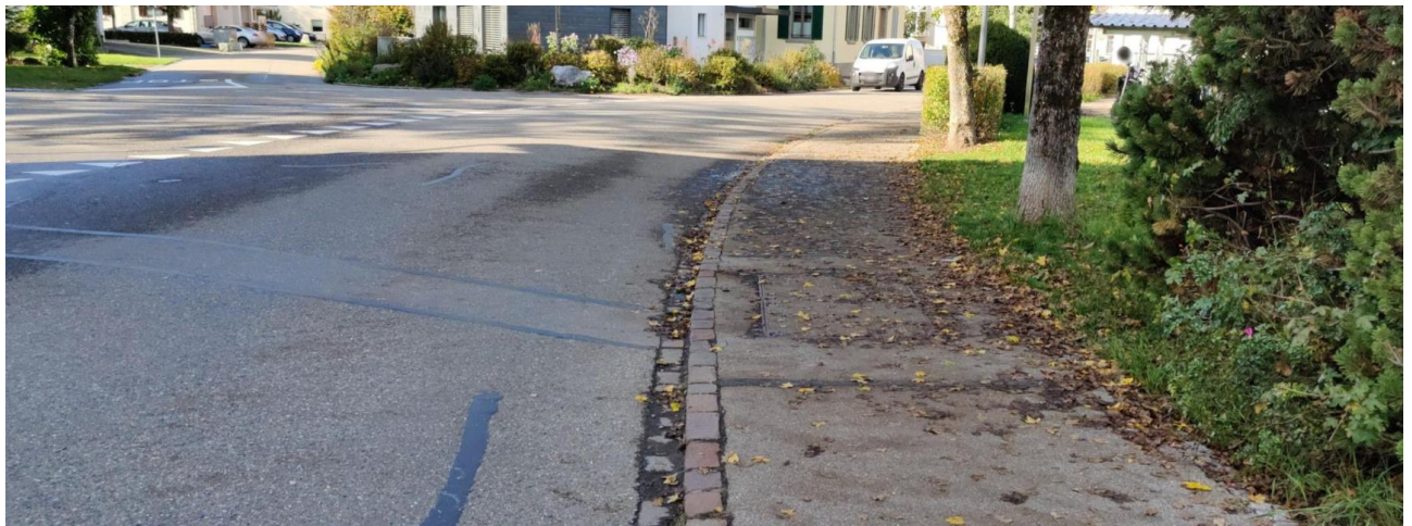
Abbildung 2: Zustand der Strasse im Bereich Tablatstrasse / Stationsstrasse
